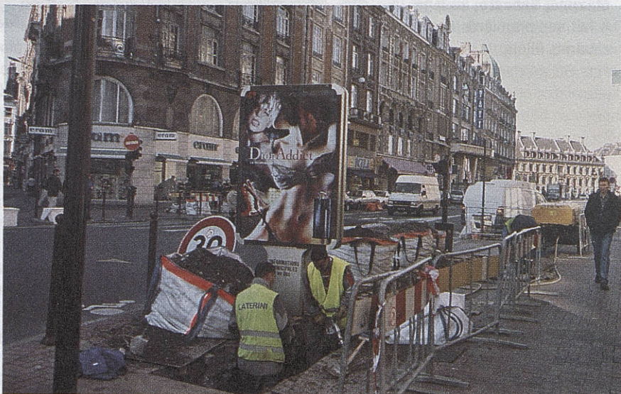
D'importants travaux commencent rue Faidherbe pour son aménagement en promenade urbaine en 2004. Une première réunion d'information est prévue le 24 octobre à l'espace Baïetto (ex-caserne Souham).
