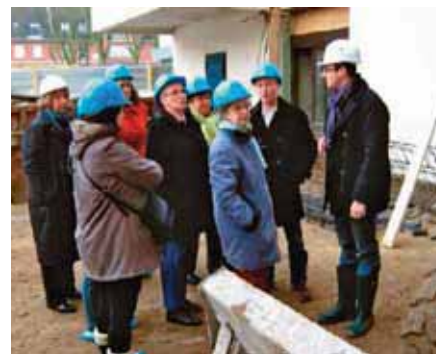
À Wazemmes, visite de chantier du centre petite enfance avec le comité d'usagers de la résidence Magenta-Fombelle.
