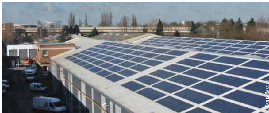
Sur le toit du Centre technique municipal, 1 900 m 2 de panneaux solaires photovoltaïques ont été installés.
