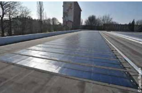
Le Jardin des Sports, nouvel équipement sportif situé entre Faubourg de Béthune et Wazemmes, a été équipé de 650 m 2 de panneaux solaires photovoltaïques.
