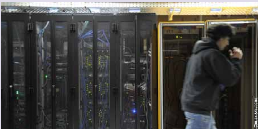
La SNCF a le centre informatique le plus pointu du monde ferroviaire. Quatre-vingts millions de messages transitent ici chaque jour et sont gérés par des serveurs informatiques (voir encadré ci-dessous).
